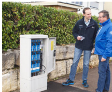
Der Energieversorger ESF setzt auf die innovative Messtechnik von EFEN im Kabelverteiler.
